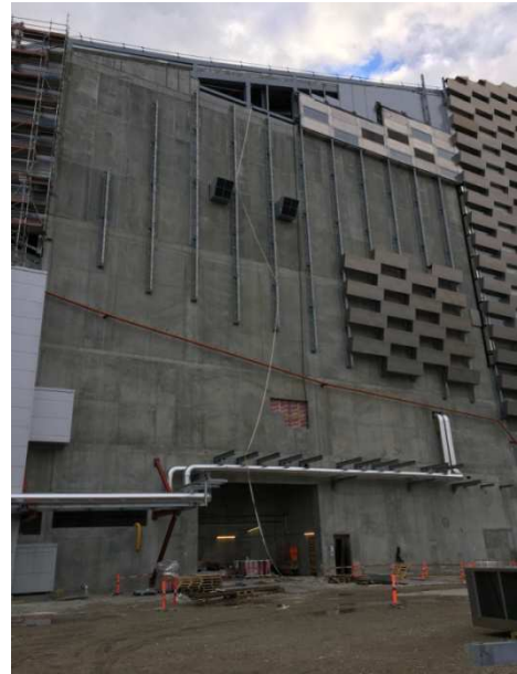
Obr. 2 stěna s bricky
