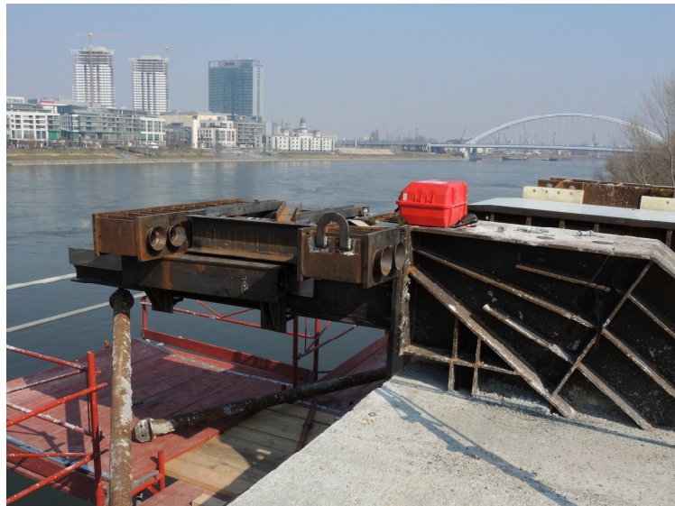
Obr. 8. Výsuvné zařízení na nábrežním pilíři
